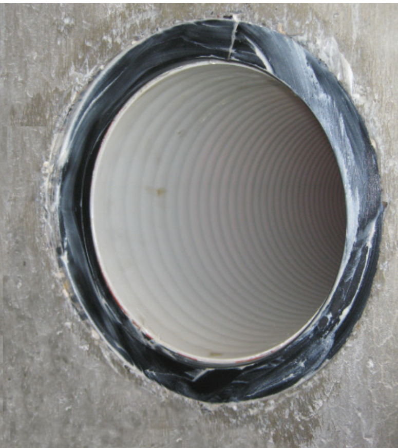
Inget instick av rör i brunn på insidan
