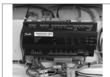
Bilde 5: Midlertidig kabling
