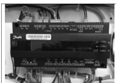
Bilde 4: Normal kabling
